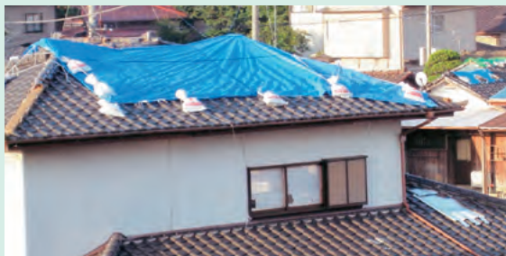
屋根瓦の損壊
